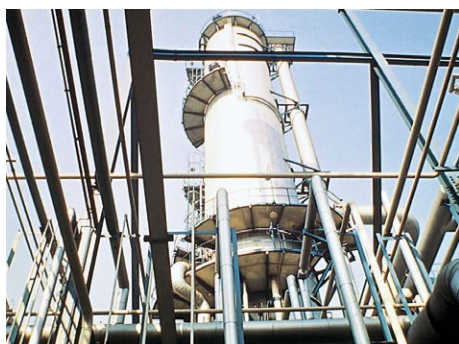
化学工場の配管
