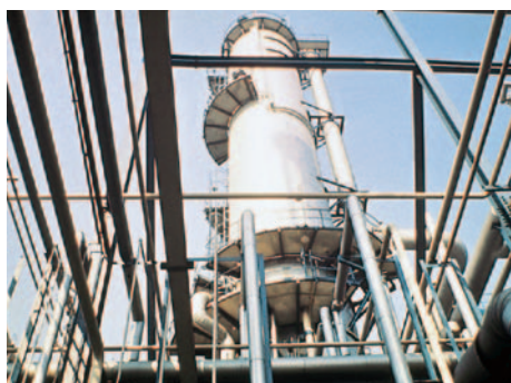
化学工場の配管
