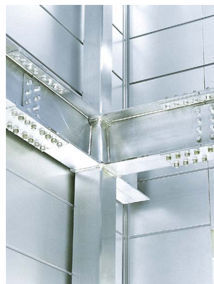
ステンレス製柱・梁
