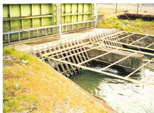
用水路のスクリーンパネル
