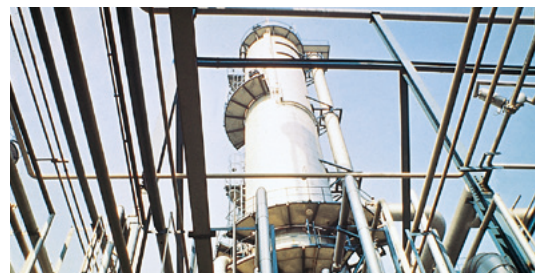
化学工場の配管
